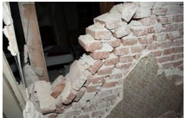
Figura 14. Comportamento di una parete in muratura di soli diatoni dopo il sisma abruzzese del 6 aprile 2009.
