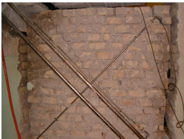
Figura 13. Pannello n. 7 a Foligno. Muratura di mattoni tessuta per soli diatoni con malta cementizia. Per tale pannello si ha IQM = 7 e la prova diagonale ha fornito: \tau_0 = 15,3 \text{ N/cm}^2 .
