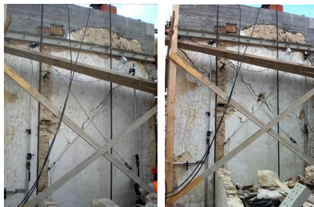
Figura 8. A sinistra, danno rilevato al termine dell'applicazione del carico in direzione positiva. A destra, quello rilevato in una fase intermedia con carico negativo.
