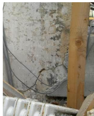
Figura 12. Danno esteso oltre la sezione di base del pannello nella porzione di vincolo (lato interno)
