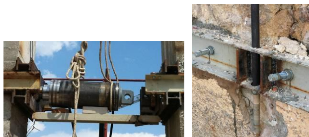
Figura 4. A sinistra, particolare dell'attacco dell'attuatore oleodinamico. A destra, particolare dell'ancoraggio delle barre agli UPN.
