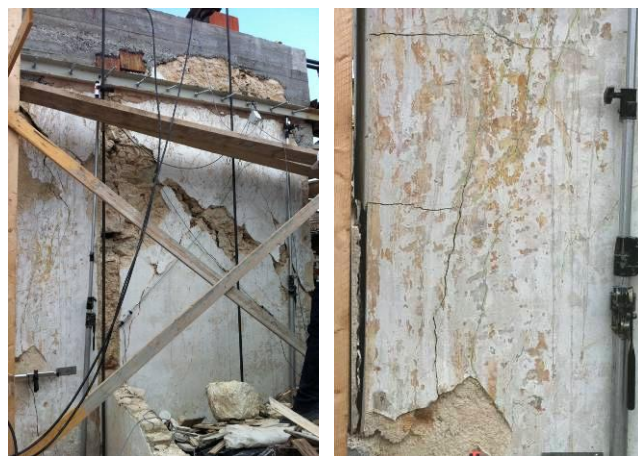
Figura 9. A sinistra, danno rilevato al termine della prova. A destra, lesioni alle estremità del pannello associate alla risposta flessionale.
