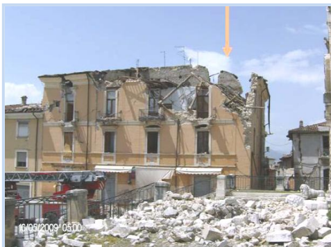
Figura 1. Foto fabbricato dopo il sisma del 6 aprile 2009.
