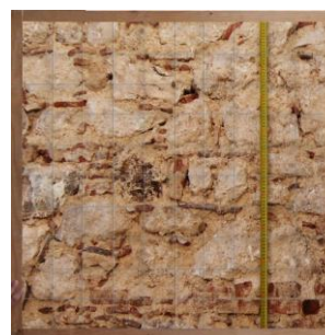
Figura 5. Campionatura muratura in situ, 1m x 1m, rappresentativa del modello tipologico locale aquilano
